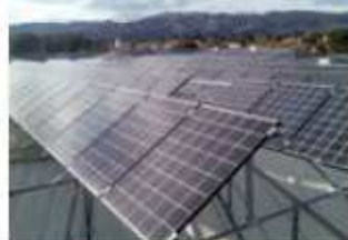
Solar fotovoltaica de conexión a red sobre cubierta de nave industrial
